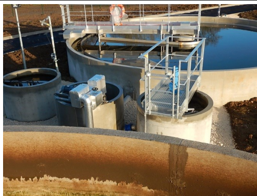
Clarificateur et ouvrages annexes
